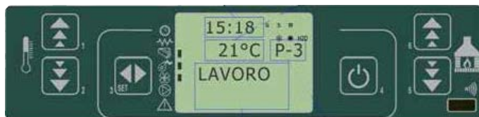
fig. 28 painel de comandos - condição de funcionamento
